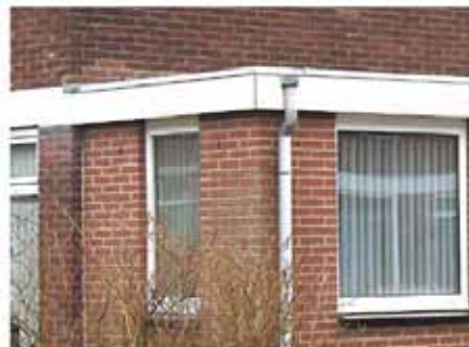
voldoet niet, de detailtering is te grof
