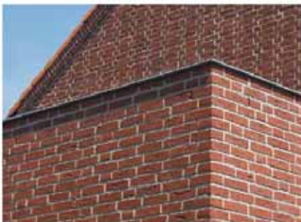
goede detailtering, met een zinken kraalrand in plaats van een boeiboord of dakoverstek, de regenpijp is in de spouwmuur opgenomen.
