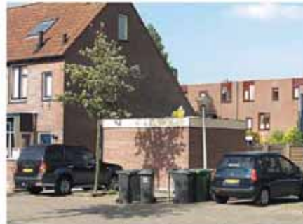
voldoet niet, te gesloten aanbouw
